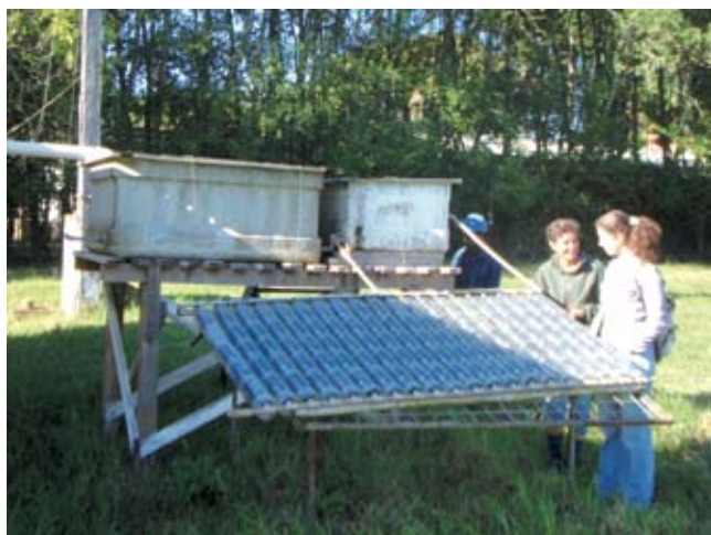
Les bouteilles en plastique, lorsque le soleil les éclaire, jouent le rôle d'une serre, effet accentué par la peinture noire du tube qui passe à l'intérieur de celles-ci. La température de l'eau qui passe dans le tube augmente. Il n'y a pas de moteur, la circulation de l'eau se fait physiquement, du fait du gradient de température ainsi créé.
